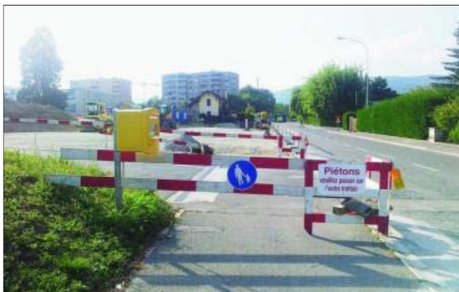
Les travaux (ici, le long de la route des Quatre-Communes) devraient se terminer en octobre prochain.
