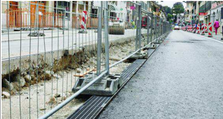
Malgré les frimas de cet été, le basculement du chantier a bien eu lieu durant la seconde quinzaine d'août. L'activité se poursuit dorénavant côté lac. CÉLINE REUILLE
