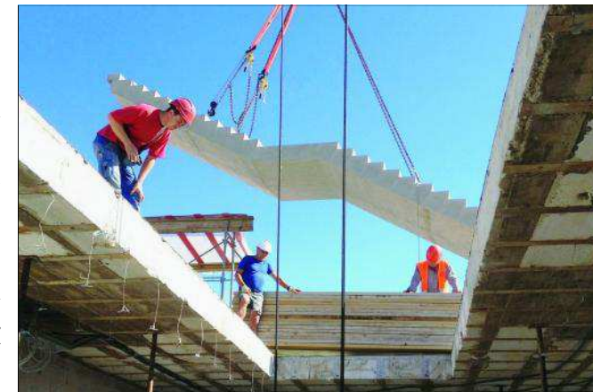
La livraison des escaliers, le «gros morceau» du chantier, selon Sébastien Meylan.
